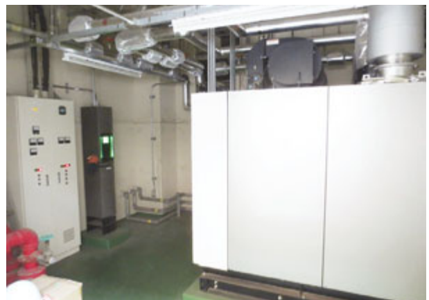
貫流ボイラ運転台数の最適化
