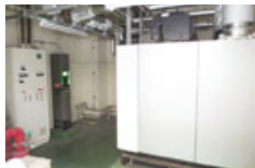
貫流ボイラ運転台数の最適化(医学部・医学系研究科・附属病院)
